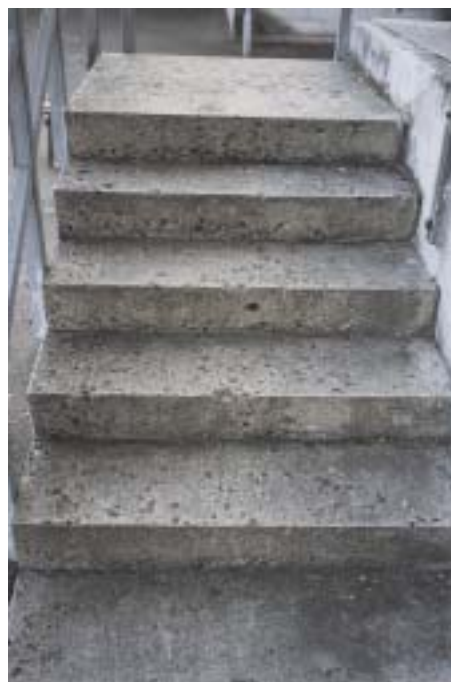
Stærkt nedslidt trappeoverflade
