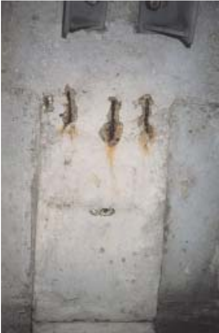
Dæklagsskade på tagbjælkes vederlag
