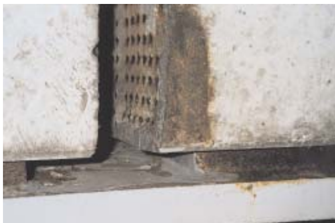
Korrosion på vederlagsplade og strengbetonbjælke
