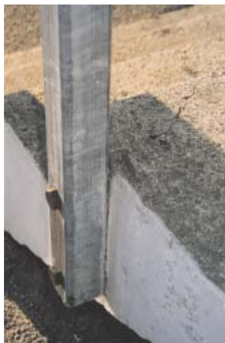
Brud ved rækværksfastgørelse
