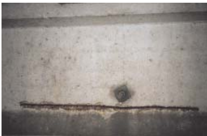
Dæklagsskade ved strengbetonbjælke
