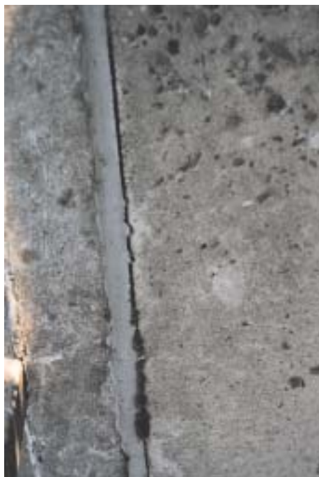
Defekt fuge mellem trinelement og brystværnsvæg
