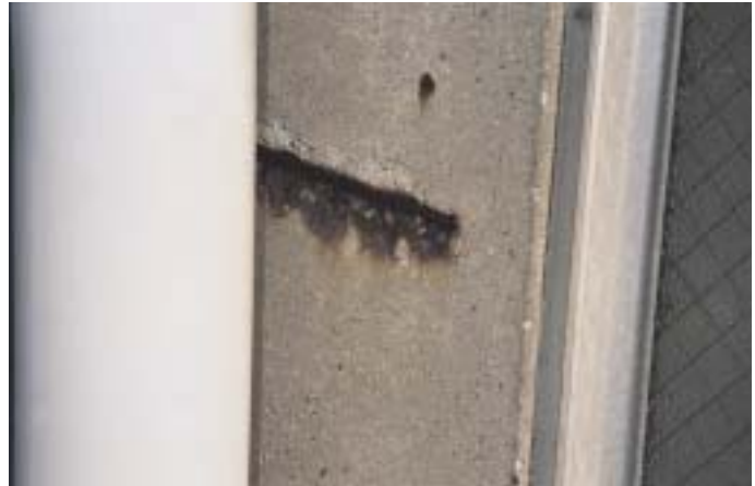
Dæklagsskade på facadesøjle
