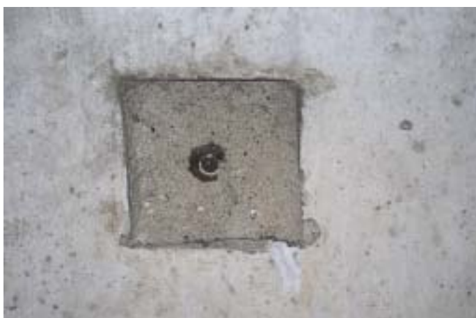
Løs udstøbning og korrosion i inserts
