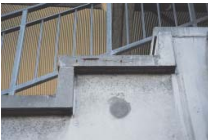
Dæklagsskade på trinelement
